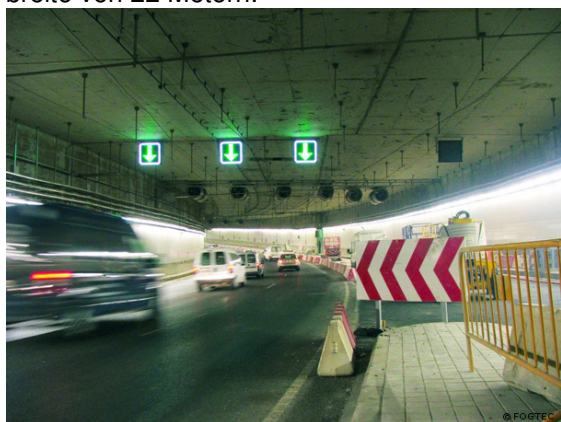
FOGTEC Anlage in Tunneln der M 30
